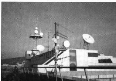
... mit den zugehörigen Antennen auf dem Dach.
