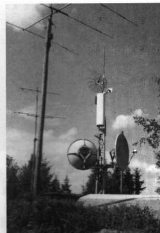
Hier ist DBØHOL untergebracht.
