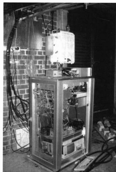
Alles in einem Gestell: DBØGD-Baken, Wetterstation und Interlinkdigi DBØRHN auf dem Heidelberg/Rhön.
